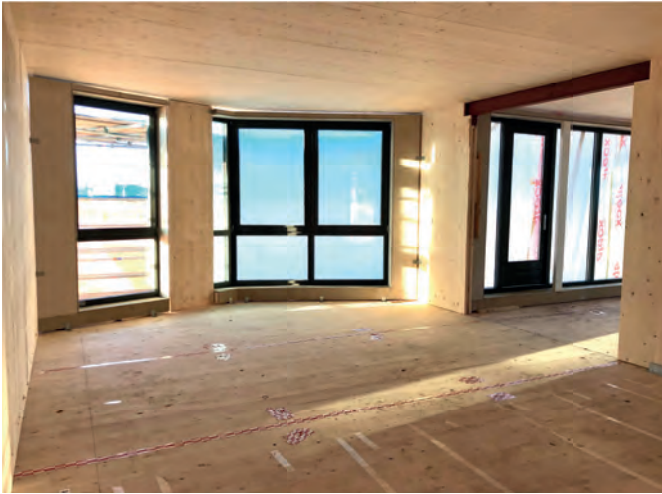
De proefwoning in aanbouw: zowel de wanden als de vloeren zijn in CLT.
